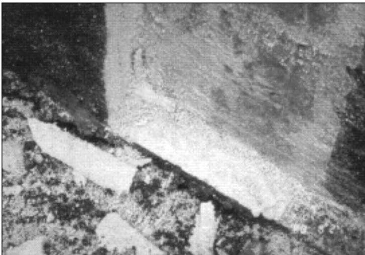
Figure 8. Mousse de polyuréthane pulvérisée sur le mur de béton et de la semelle. On peut apercevoir des restes de mousse adhérant sur le béton.
